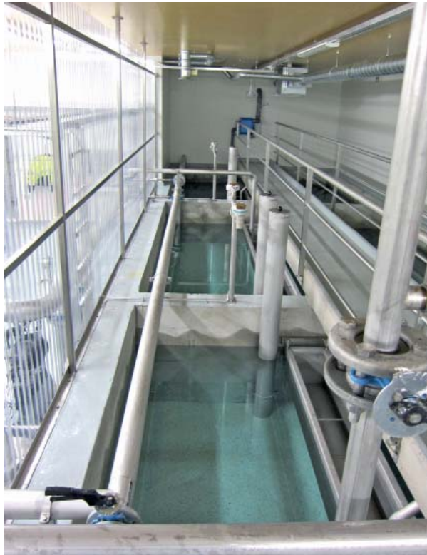
Vartin laitoksen kalkkikivialtaat. Kalkkikivi tasaa veden pH-arvoa.
