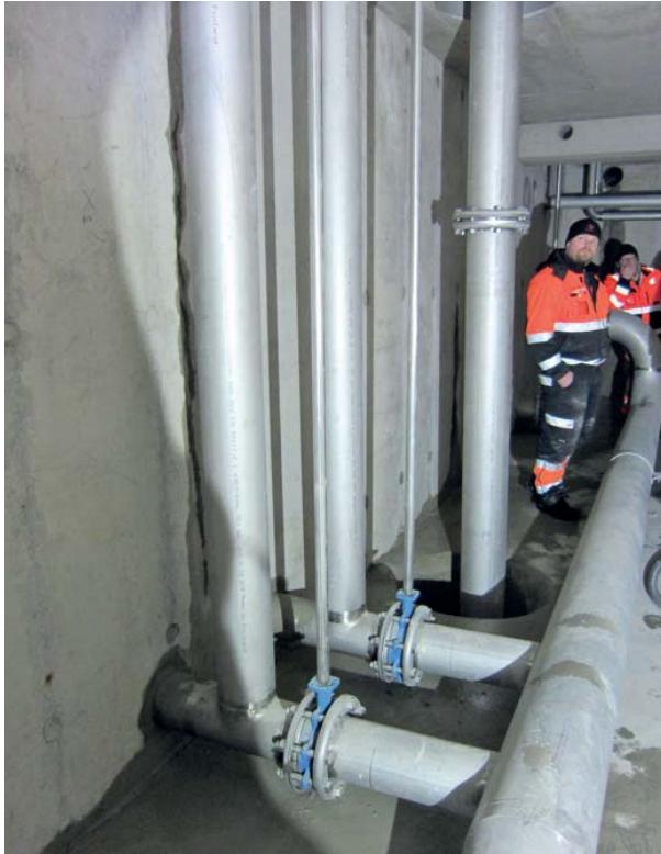
Vartin vedenkäsittelylaitoksen alavesisäiliön putkistoa.
