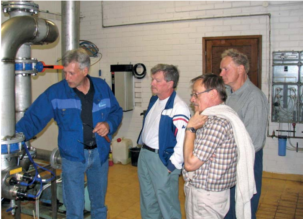
Yhtiön hallitus tutustumassa Keltalan raudanpoistolaitokseen. Laitosta esittelee Hannu Kähkölä, kuunteluoppilaina Seppo Junttila, Tauno Konola ja Matti Ranta.
