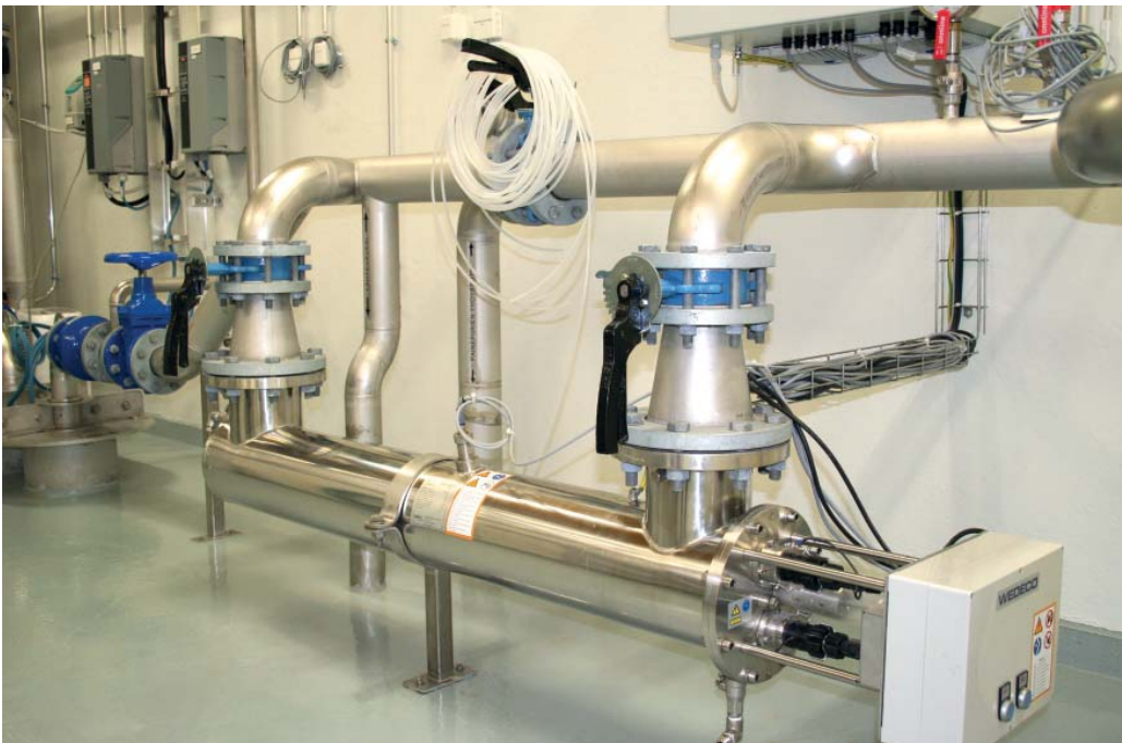
Vedenkäsittelylaitoksen uv-sterilisaattori. Paavolan Veden jokaisella vedenottamolla on uv-laitteisto ja kaikki verkostoon johdettava vesi virtaa laitteiston läpi.
