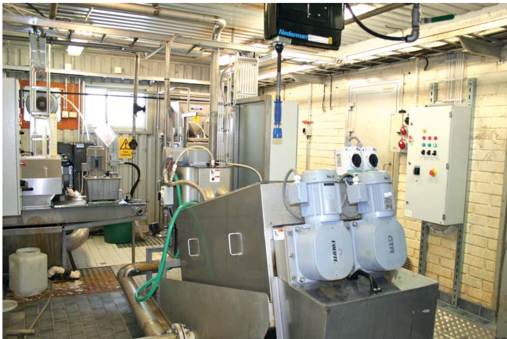
Ruukin jätevedenpuhdistamon uusi lietteenkuivauskone otettiin käyttöön 2011.
