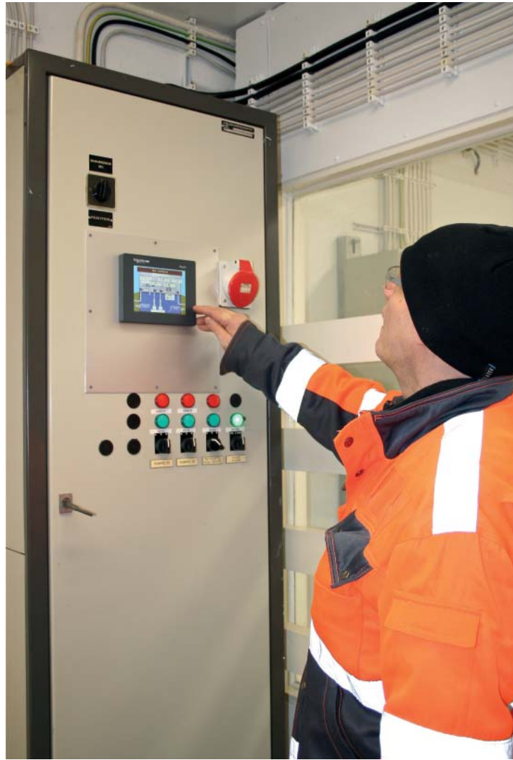
Tuomiojan välipumppaamon ohjaustaulua käyttämässä Seppo Rantoharju.
