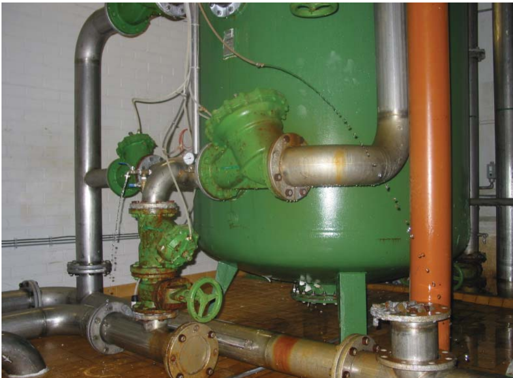
Keltalan raudanpoistusuodatin. Vesihanat on avattu näytteen ottamista varten.
