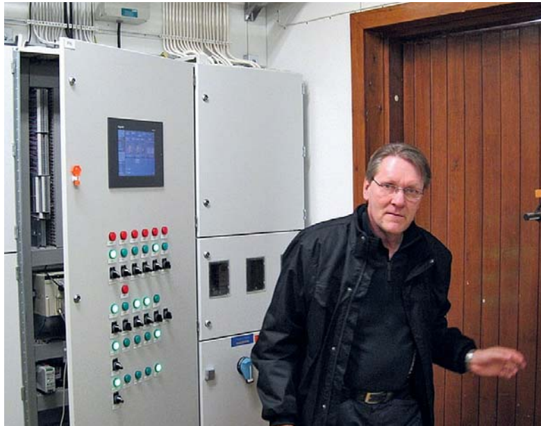
SLATEK Oy:n Risto Huuki tarkastamassa Keltalan vedenottamon sähköpääkeskusta.
