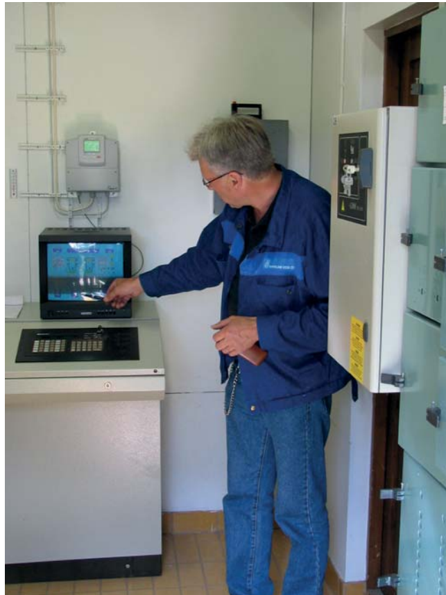
Hannu Kähkölä esittelee vedenottamon automatiikkaa.
