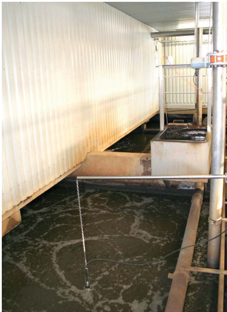
Ruukissa jätevedet puhdistetaan biologis-kemiallisella rinnakkaissaostus- menetelmällä.. Likavesialtasiin pumpataan ilmaa, jotta vettä puhdistavat bakteerit toimisivat jatkuvasti.
