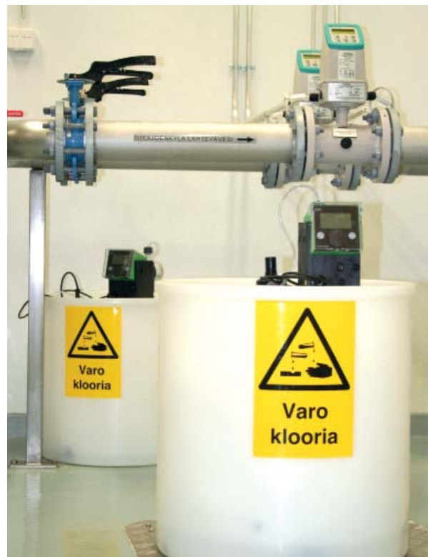
Vartinvaarassakin on klooria varastossa verkoston saastumisen varalta. Vesijohtoverkoston kloorataan vain poikkeustapauksissa.
