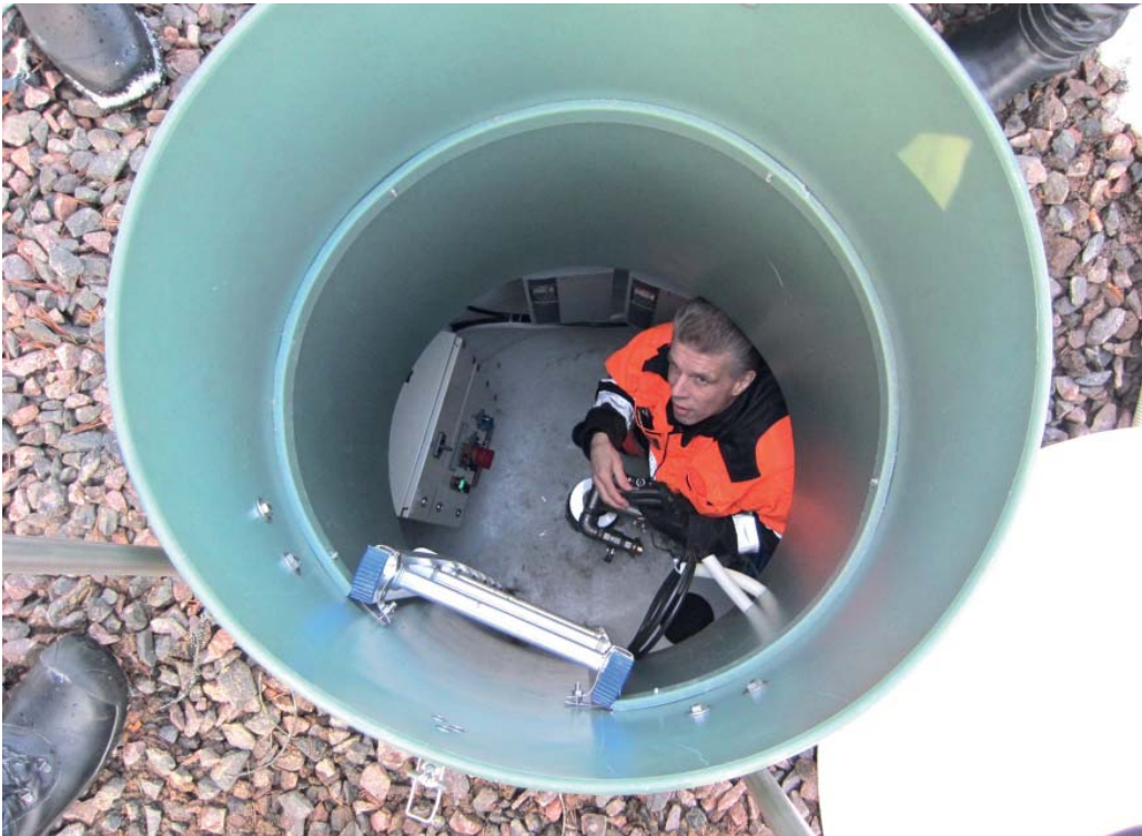
Limingan Vesihuolto Oy:n toimitusjohtaja Markku Komulainen Vartinvaaran kaivon suojasäiliössä.
