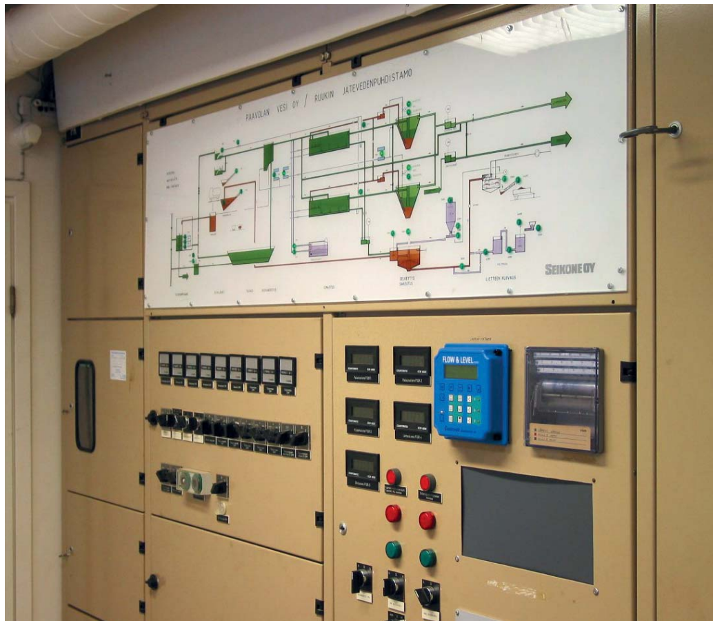
Ruukin jätevedenpuhdistamon sähköpääkeskus.
